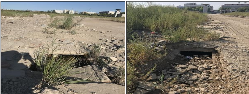
图 2-12 场地内裸露排水明渠
